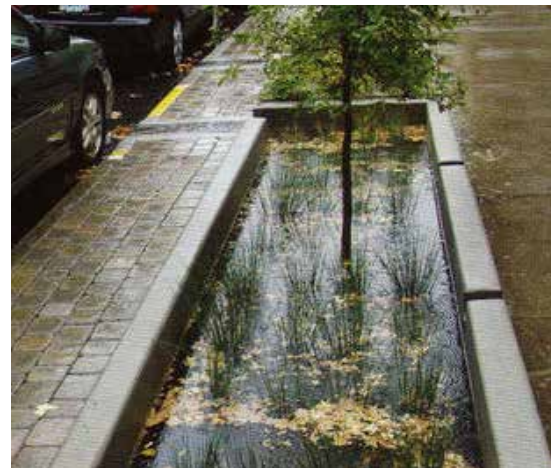
Référence de jardin de pluie le long d'une voirie, en temps pluvieux
