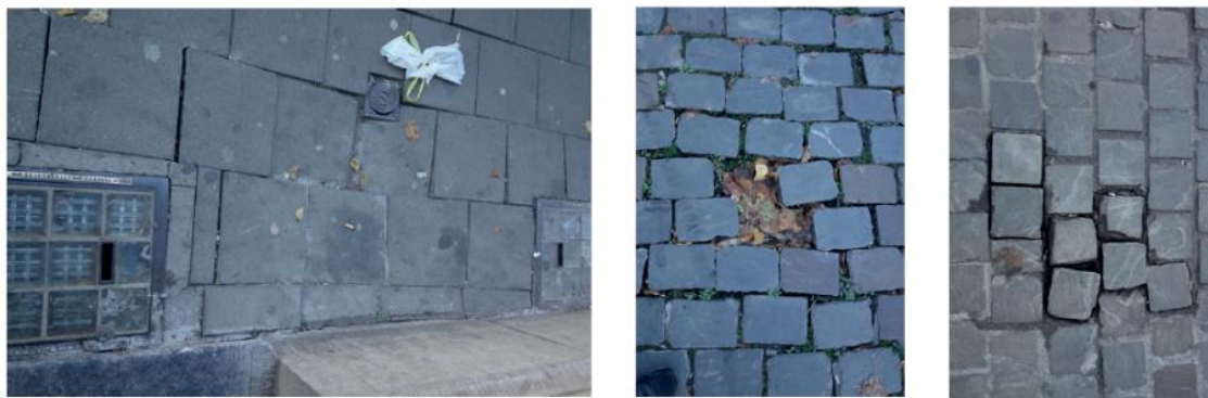
Figure 172 : Etat dégradé de certains trottoirs au sein du périmètre (A-Practice, 2018)
