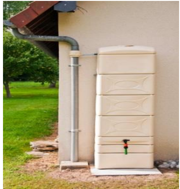
Système de récupération des eaux pluviales en façade
